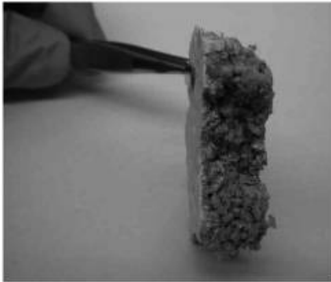
Intonaco costituito da amianto e vermiculite, materiale friabile
