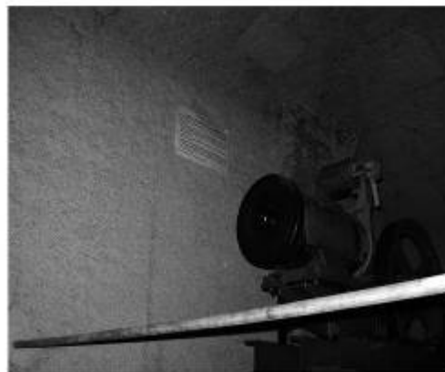
Rivestimento delle pareti e del soffitto del locale macchinario ascensore (vermiculite espansa e crisotilo); materiale friabile
