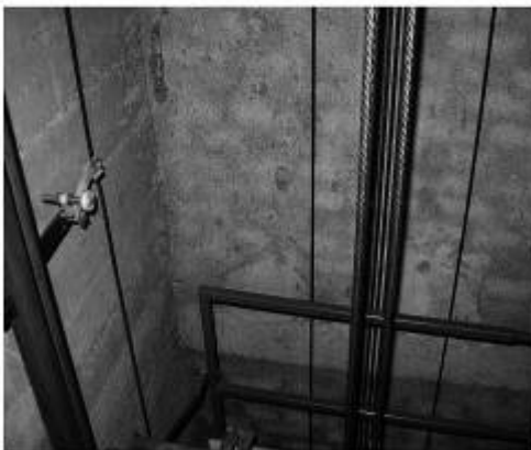
Vano corsa ascensore; rivestimento della parete con vermiculite espansa e crisotilo, materiale friabile
