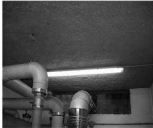
Rivestimento del soffitto di una Centrale termica; materiale friabile
